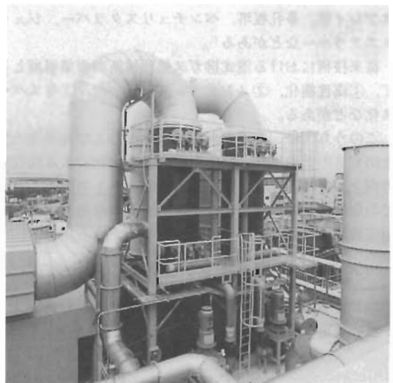
写真2 脱臭装置全景
