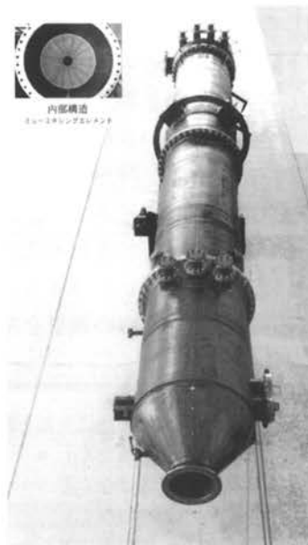
VOC放散塔 φ1500×18mH 処理液量：600m 3 /hr
