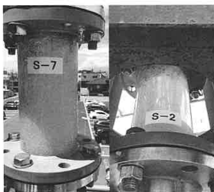
写真1 スパーサ部における気・液混相流
