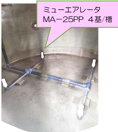
写真-2 ミューエアレータを用いた脱硫塔内の攪拌水槽
